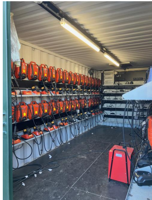
Foto van de container waar de accu's opgeladen worden, tbv. klein materieel
